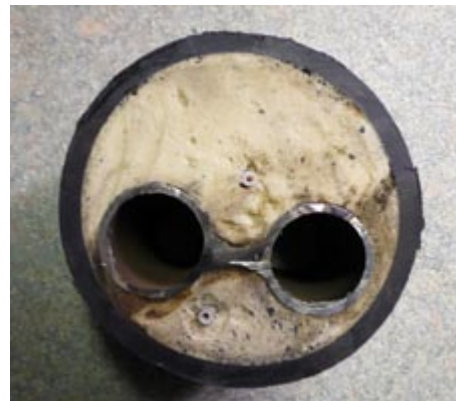
Fot. 5. Nieprawidłowe wykonanie podwójnej rury preizolowanej
