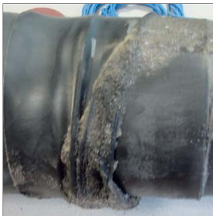
Fot. 12 Nasuwka termokurczliwa usieczowana z dodatkowym zabezpieczeniem na końcach w postaci opasek termokurczliwych. Opaski uległy zniszczeniu ze względu na złe dobrany materiał
