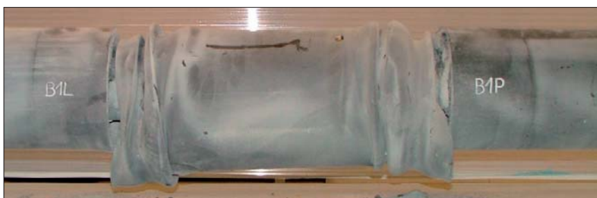
Fot. 13 Nieprawidłowo wykonana nasuwka z usieczowanego HDPE (brak kleju) na końcach nasuwki
