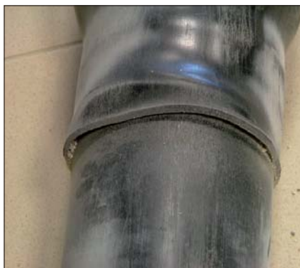
Fot. 11 Nasuwka termokurczliwa nieusieczowana z HDPE. W czasie badania nastąpiło odkształcenie na skutek przerwania procesu obkurczania
