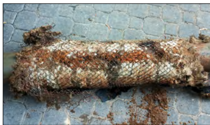
Rys. 1. Braki w izolacji włóknistej na rurociągu Fig. 1. Gaps in fibrous insulation on a pipeline
