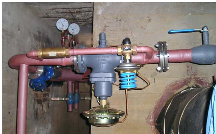
Fotografia 1. Pilotowy regulator różnicy ciśnień zainstalowany w komorze ciepłowniczej.
