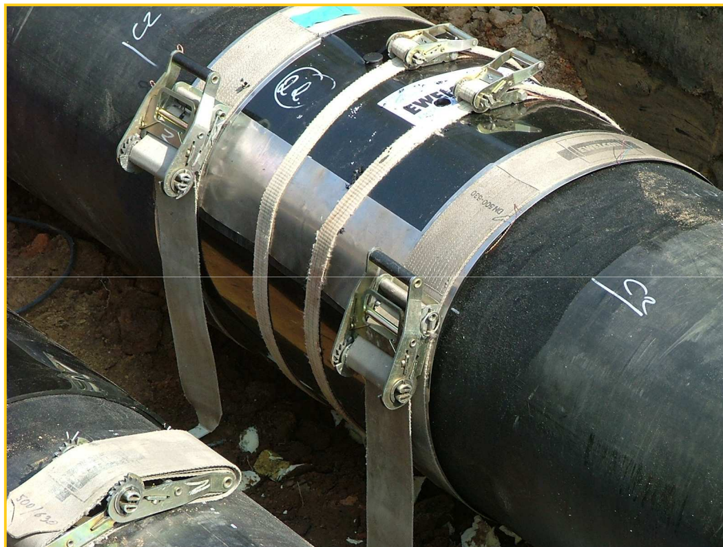
Montaż mufy zgrzewanej elektrycznie prod. BRUGG
